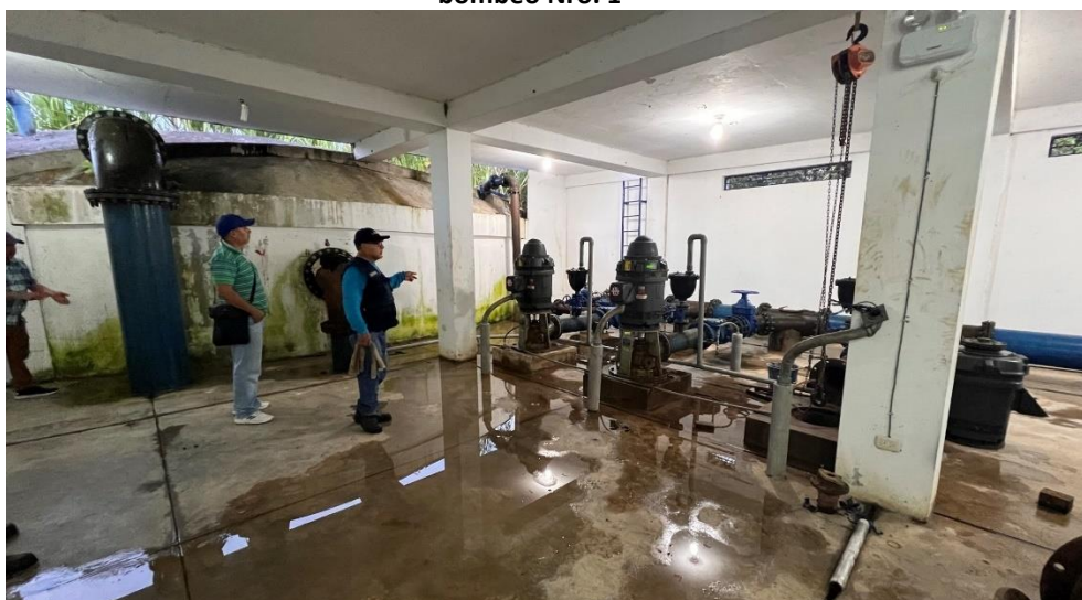
Imagen N° 6: Vista del cuarto de máquinas que se inunda por fuga de agua en el equipo de bombeo Nro. 1
