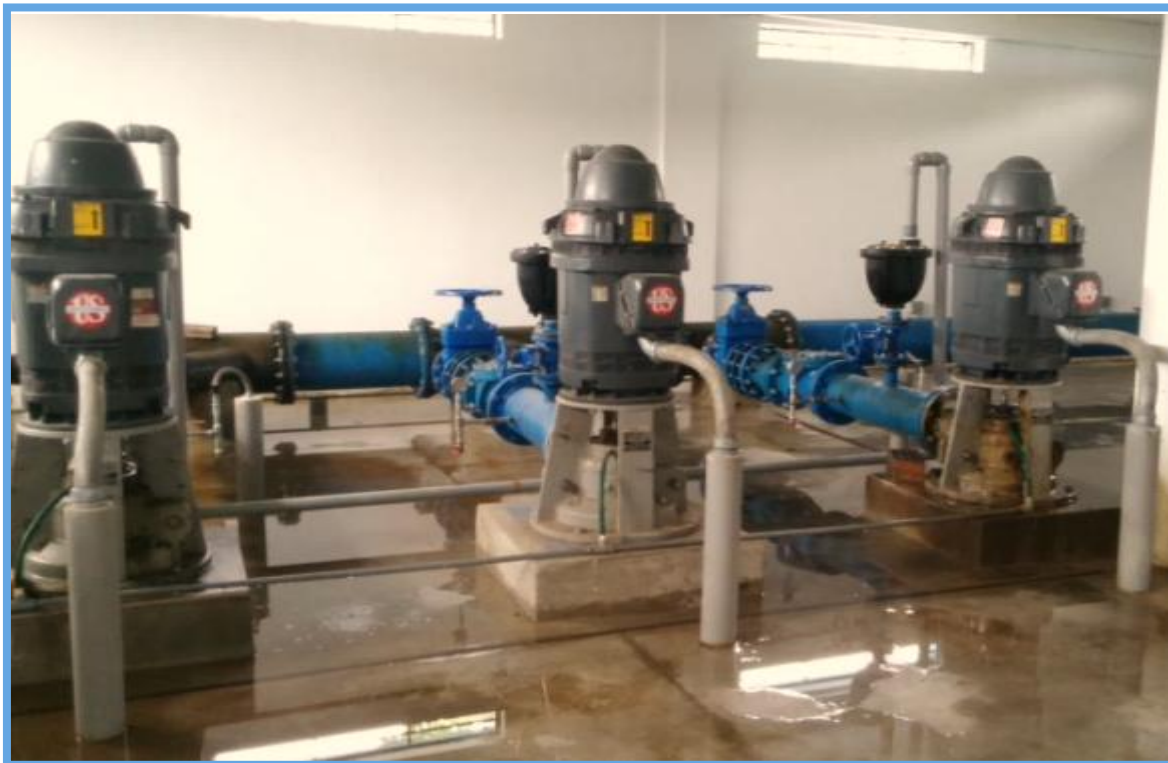
MOTORES DEL TK CISTERNA 500 M3
